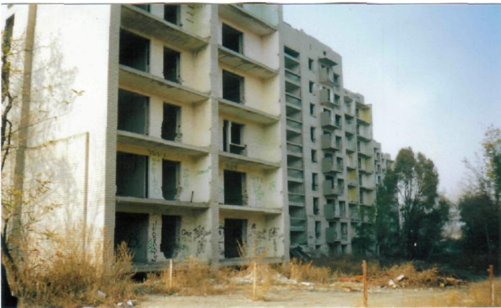
Рис. 2. Типова картина деформацій житлового будинку при нерівномірних просадках (м. Дніпропетровськ, вул. Нахімова)
